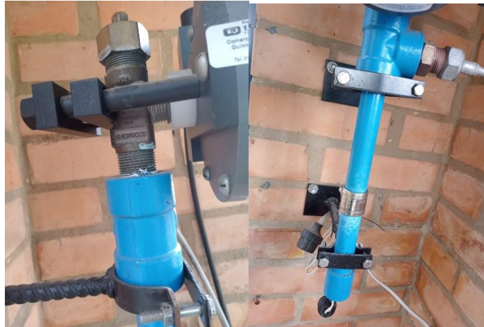
Ilustración 59 estado en que se encontró el sistema de cloración de la planta de tratamiento
