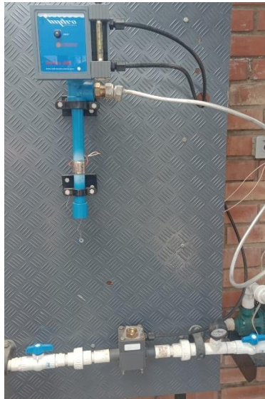
Ilustración 56 Estado en que se encontró el sistema de cloración de la planta de tratamiento
