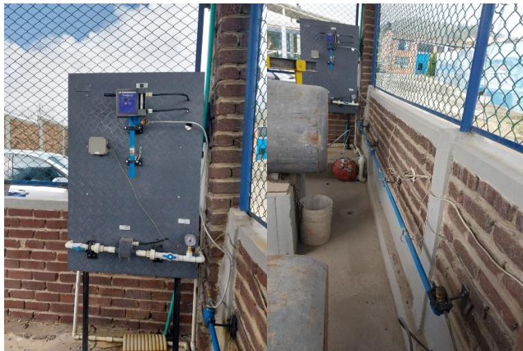
Ilustración 54 Estado en que se encontró el sistema de cloración de la planta de tratamiento
