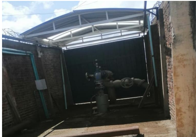
Ilustración 45 Pozo el Mirto
