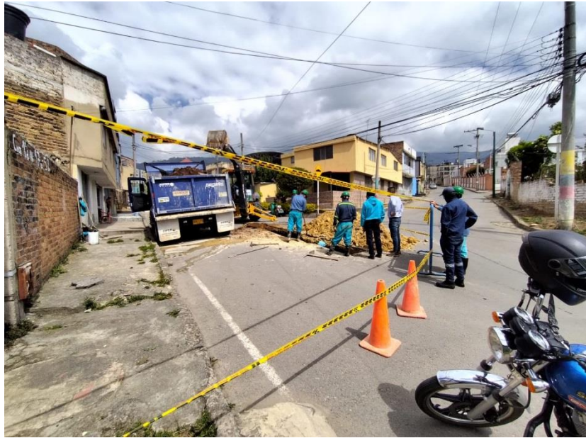
Ilustración 27 Intervención del hundimiento sobre la bóveda de la quebrada siras en la calle 16 con carrera 9ª
