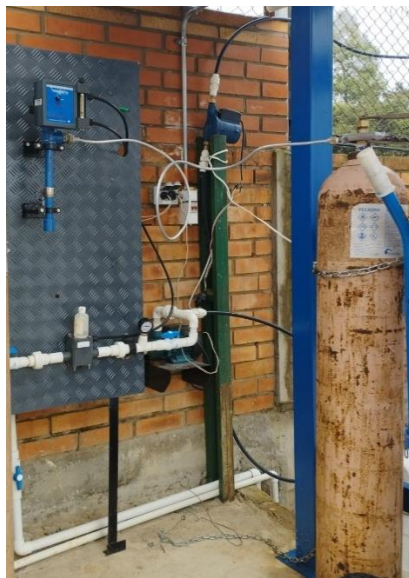
Ilustración 58 Sistema de cloración de la planta después del mantenimiento.
