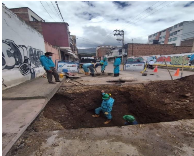
Ilustración 28 Hundimiento generado en la calle 20 con carrera 21 puestos
