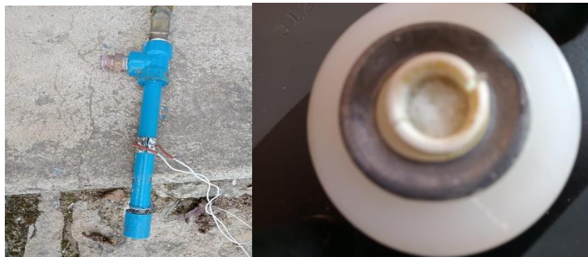
Ilustración 60 Mantenimiento de elementos del sistema de cloración
