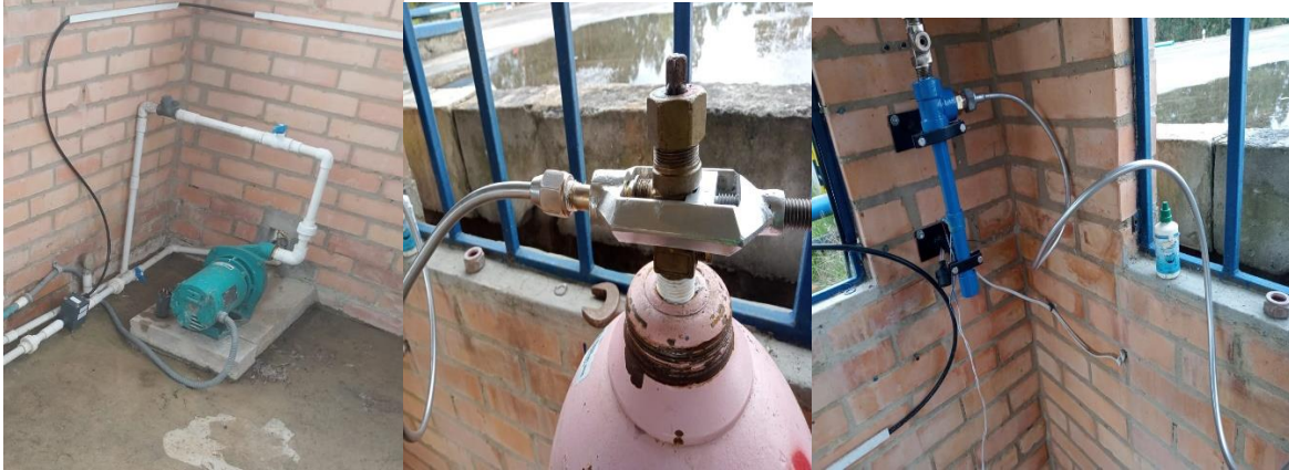
Ilustración 61 Sistema de cloración de la planta después del mantenimiento
