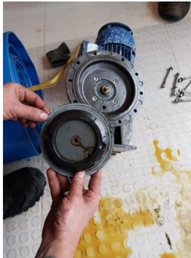
Ilustración 67 Cambio de diafragma a electrobomba dosificadora color azul 1/2hp
