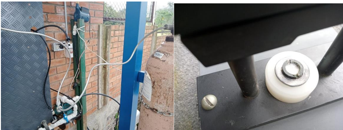
Ilustración 57 Mantenimiento de tablero y sistemas hidráulicos
