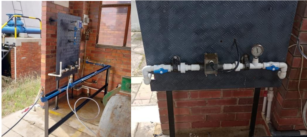
Ilustración 53 Sistema de cloración de la planta después del mantenimiento.
