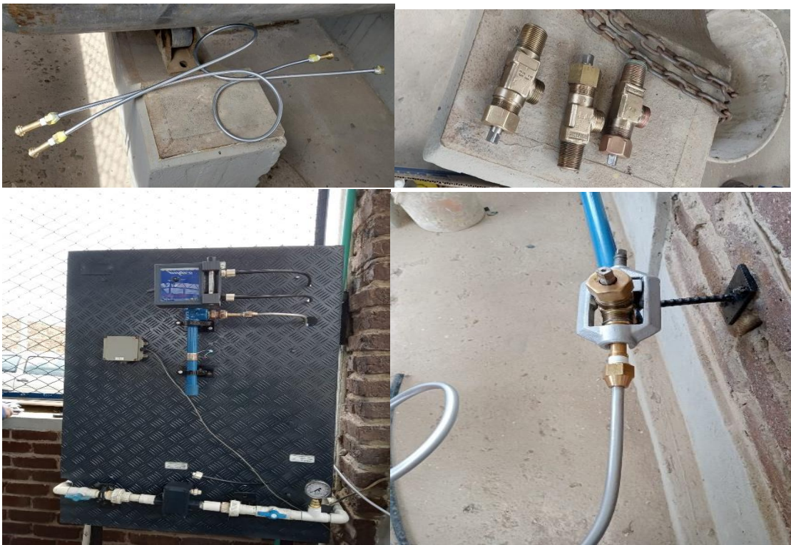
Ilustración 55 Sistema de cloración de la planta después del mantenimiento
