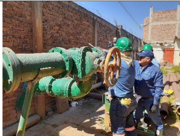
FOTO 16. Estado anterior tubería de descarga
