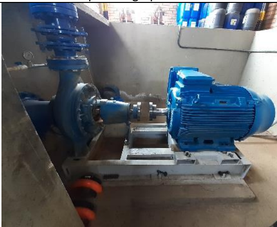
FOTO 13. Alineación acople unidad de bombeo 1
