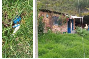
Vivienda ubicada en la K 1 # 18 - 11 conexión directa sin instalación del medidor. Queda suspendida
