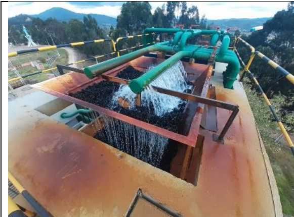
FOTO 21. Se reciben 41 L/s de caudal en la planta milagrosa después del mantenimiento
