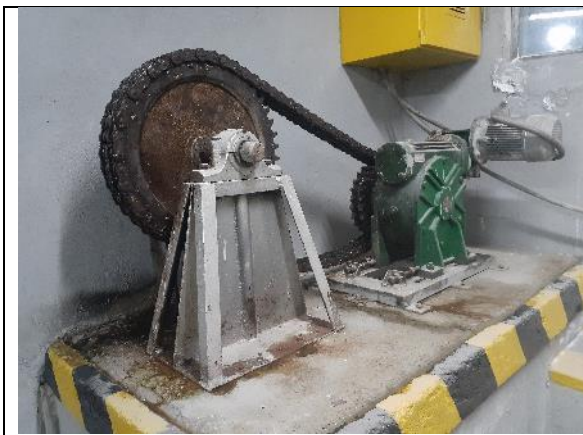
FOTO 1. Motorreductores sistema floculación antes del mantenimiento
